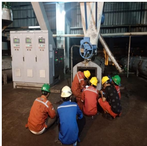
Gambar 5. Penanganan Plugging pada Coal Feeder unit 1 (Sumber: Central Control Room PLTU Punagaya)
